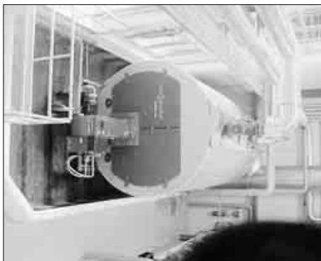
AL VAGLIO. Una centrale per il teleriscaldamento
